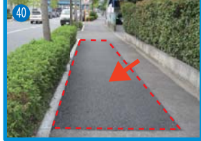
● 街路樹の根上りの処理
